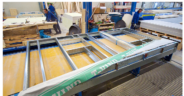
Efter avslutad vägg tillverkning placeras väggelementen på säkra transporthäckar för leverans till byggarbetsplatsen.
